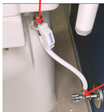
Placering af Leak Sensor
